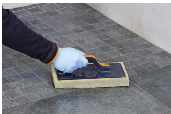
Snadné spárování s použitím epoxidové spárovací hmoty PCI Durapox® Premium. Není zapotřebí žádné speciální nářadí.
