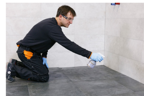
Před konečným umytím povrchu se po cca 60 minutách nastříká na zaspárovaný povrch PCI Durapox® Finish (tekutina v rozprašovači), nebo lze PCI Durapox® Finish (práškový koncentrát) přidat přímo do mycí vody.
